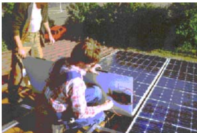
Photovoltaikanlage auf dem Dach der Tübinger Dietrich Bonhoeffer Kirche. Foto: privat
